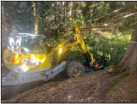
Intervention suite à une fuite située à proximité du numéro 5 du chemin des Parchets
