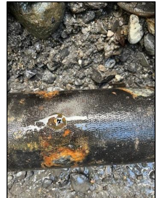
Fuite sur la conduite du Rosex
