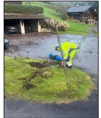
Intervention suite à un accident de la circulation au chemin des Vioz
