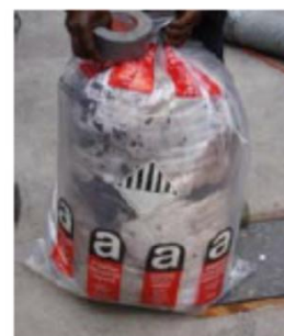
4 Sac en plastique avec marquage «Amiante»
